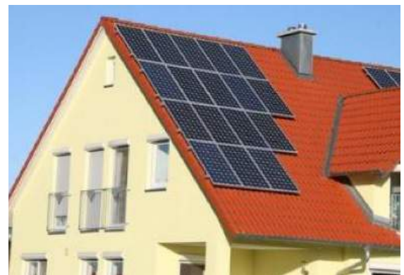
Figura 2. Casa con paneles solares.
