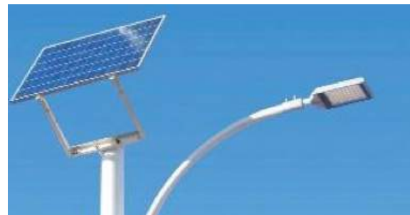
Figura 7. Lámpara que funciona con panel solar.
